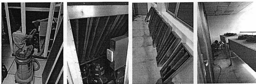
Máy lạnh tủ đứng nổi ống gió
