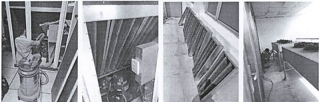
Máy lạnh tủ đứng nối ống gió
