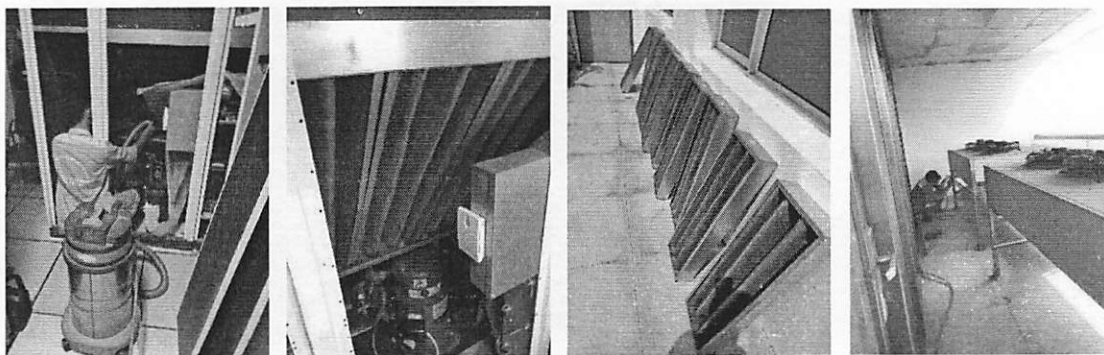
Máy lạnh tủ đứng nổi ống gió
